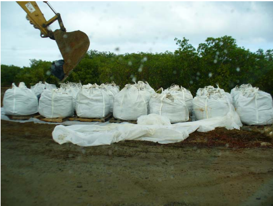
Material Peligroso empacado en sacos (17 Feb 09)
